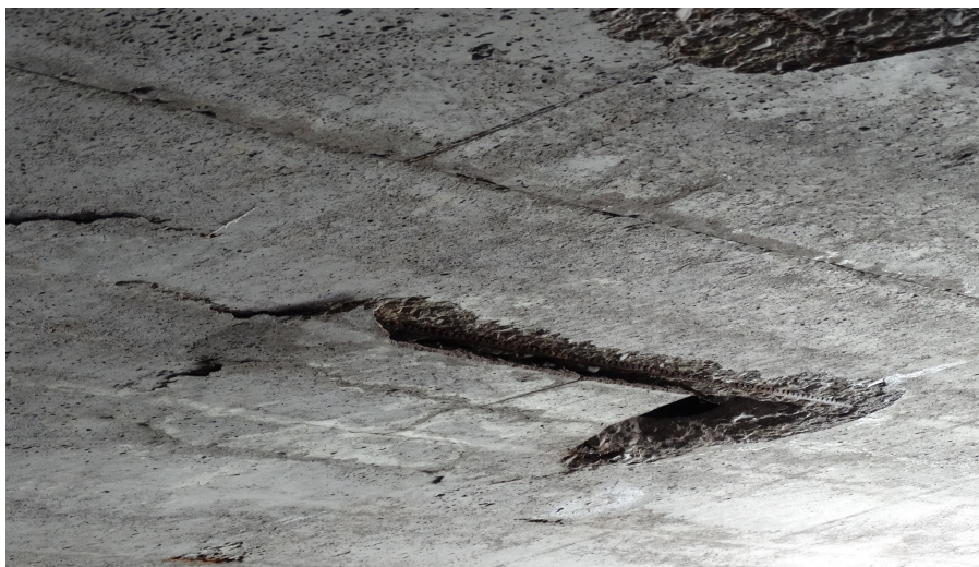
Fot.1. Rozsadzone prefabrykowane płyty kanałowe pod wpływem mrozu.
